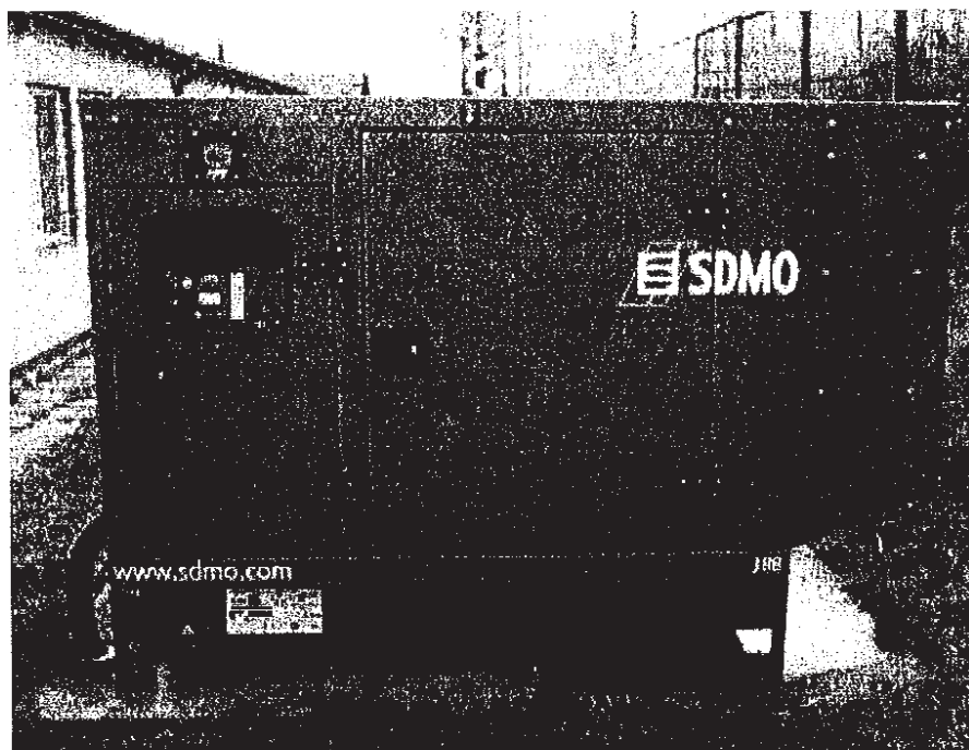
Widok agregatu SDMO / J110K Silent – przykładowa instalacja
